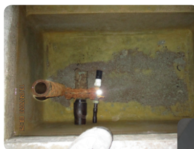
Nettoyage de l'installation à prévoir rapidement
