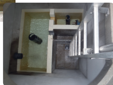
installation bien entretenue
